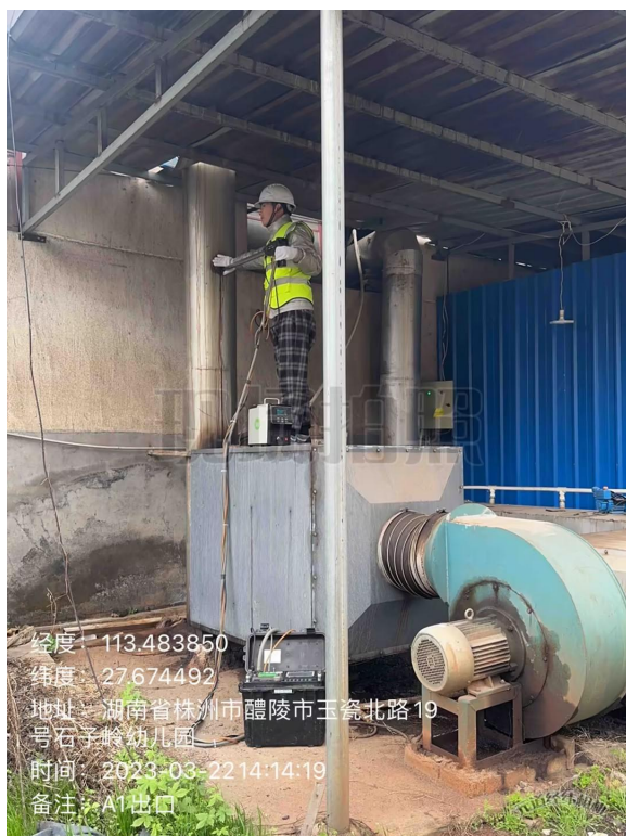
烤花废气排气筒
