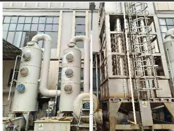
2 级喷淋塔+高压等离子设备
