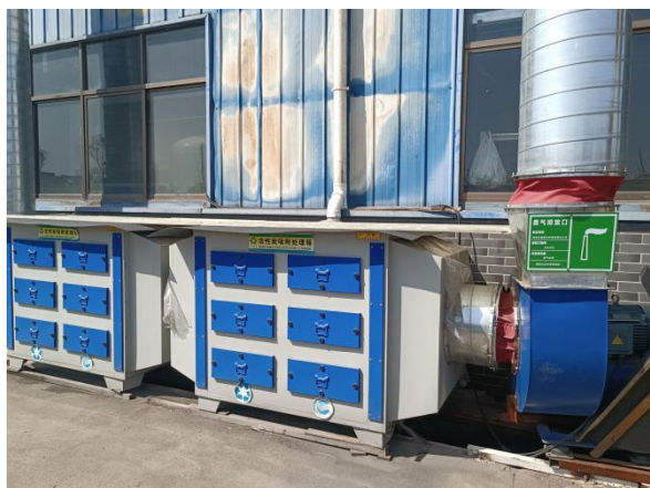
废气处理设施
